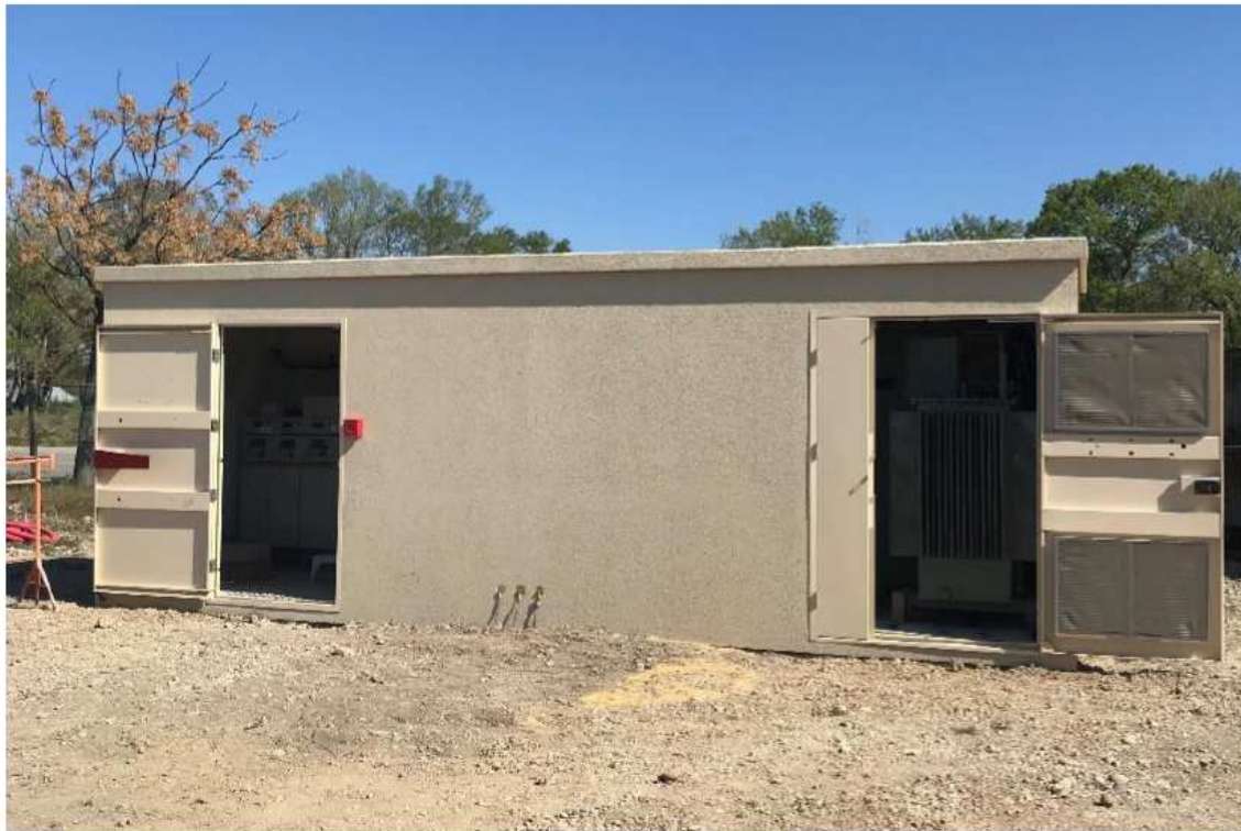
Figure 5 : Photographie d'un poste de livraison/transformation
